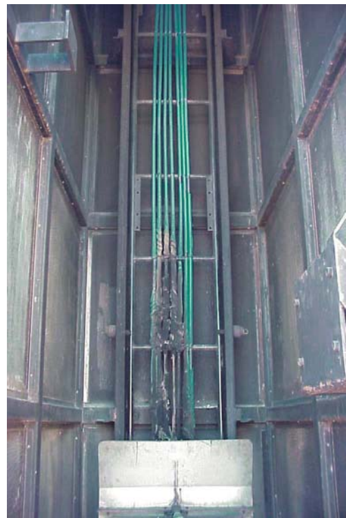
Cable alta seguridad (AS). Supera el ensayo de no propagación del incendio, sólo una mínima parte del cable resulta dañada
